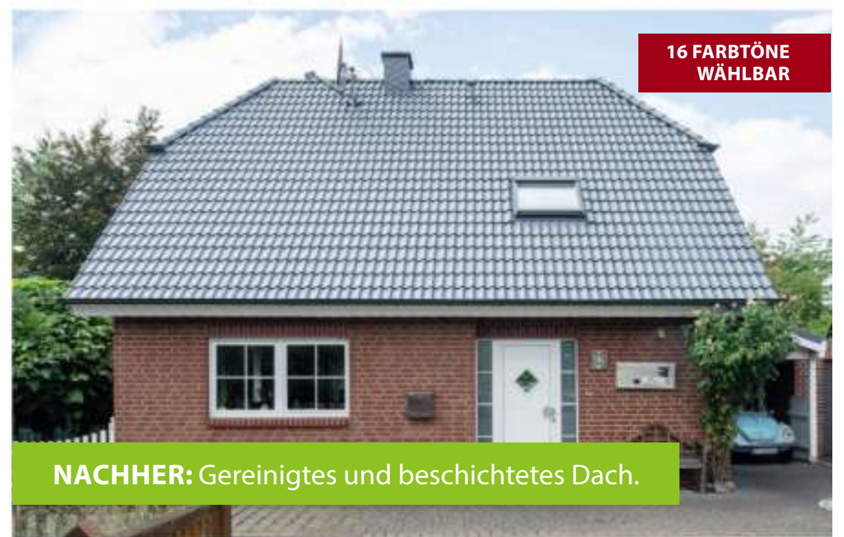
VORHER: Mit Moosen und Flechten beanspruchtes Dach.
